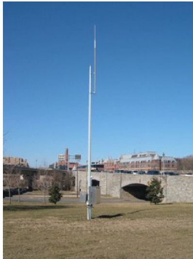
Figure 9.2: HAR antenna (Quixote Inc.)
